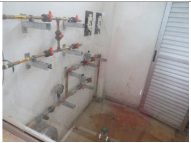
Autor: AMAE Descrição: Instalações na asa de cloração na ETA Abóboras.
