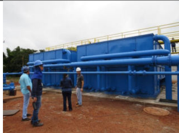
Autor: AMAE Descrição: ETA compacta.
