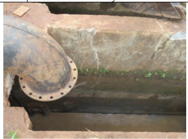
Autor: AMAE Descrição: Canal de sucção na ETA Abóboras.
