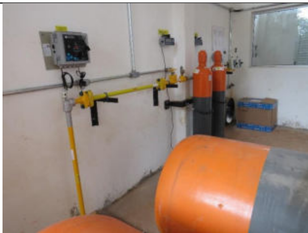
Autor: AMAE Descrição: Cilindros da Casa de Cloração.
