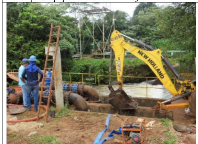
Autor: AMAE Descrição: Remoção de areia para instalação das bombas de sucção ETA Abóboras.
