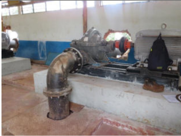
Autor: AMAE Descrição: Casa de bombas.
