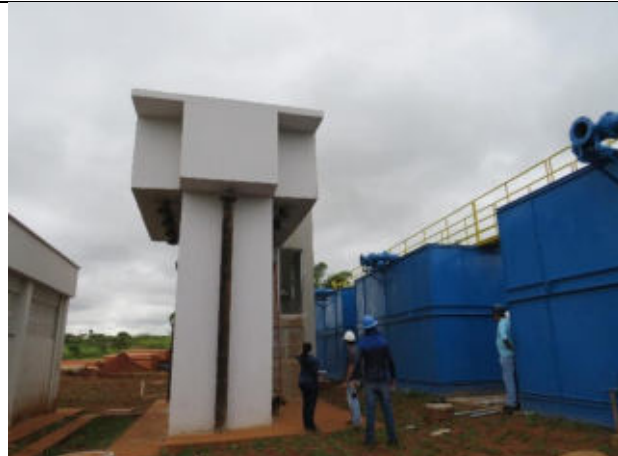
Autor: AMAE Descrição: Calha Parshall e ETA compacta na ETA Abóboras.
